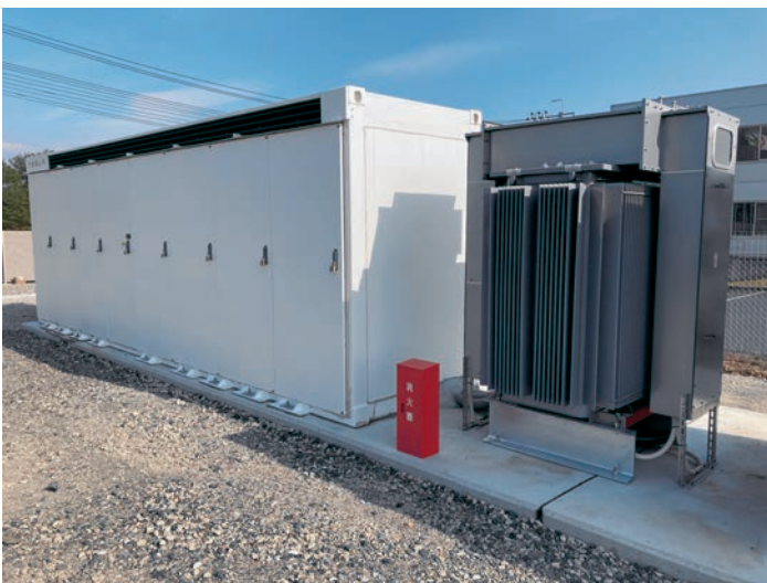
▼蓄電池システム
