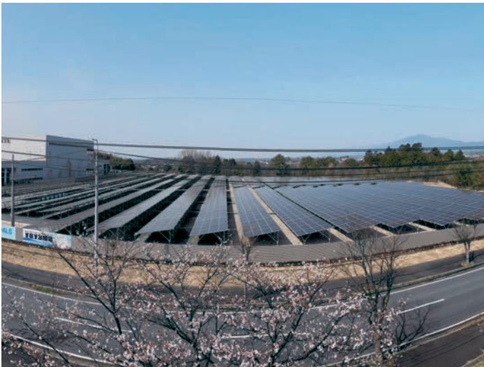
▼敷地内に設置した太陽光パネル
