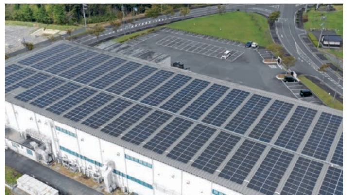
▼屋上に設置した太陽光パネル
