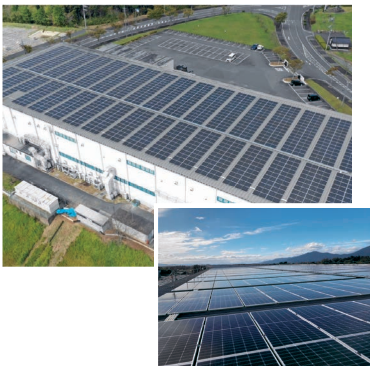
▼屋上に設置した太陽光パネル
