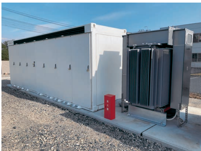
▼蓄電池システム
