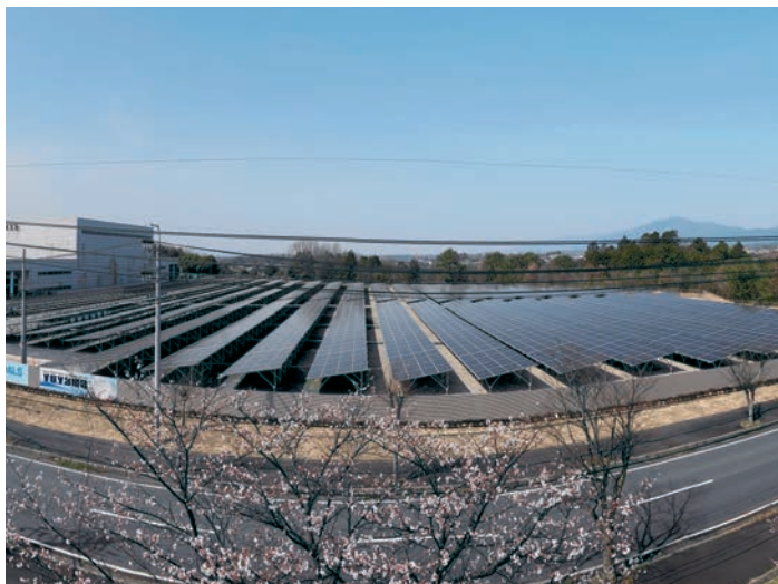
▼敷地内に設置した太陽光パネル
